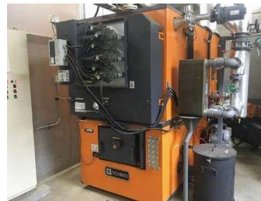
木質チップボイラーの導入 【地域熱供給施設（浦幌町）】
